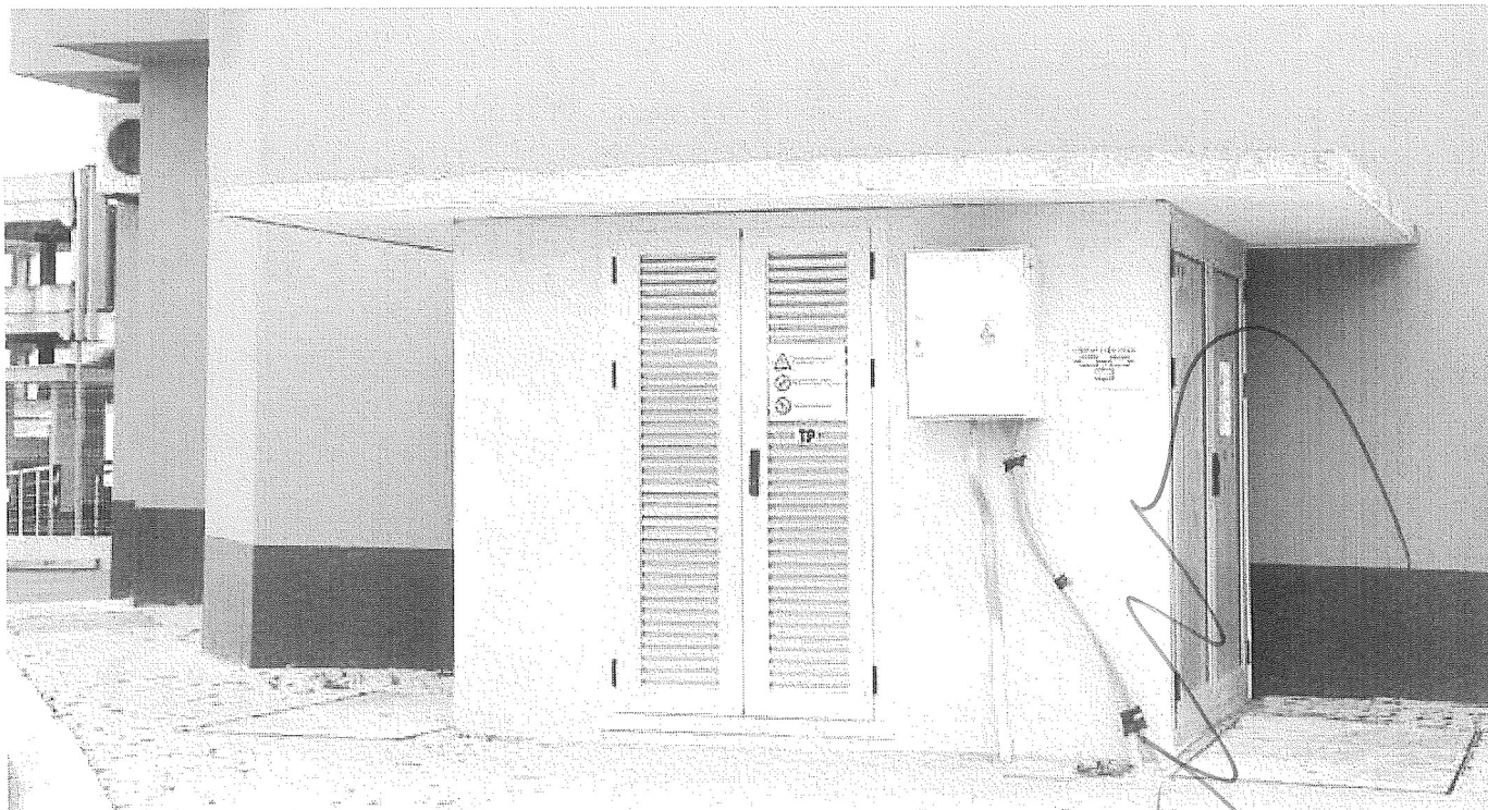
БКТП с външно обслужване – за жилищна сграда, София
